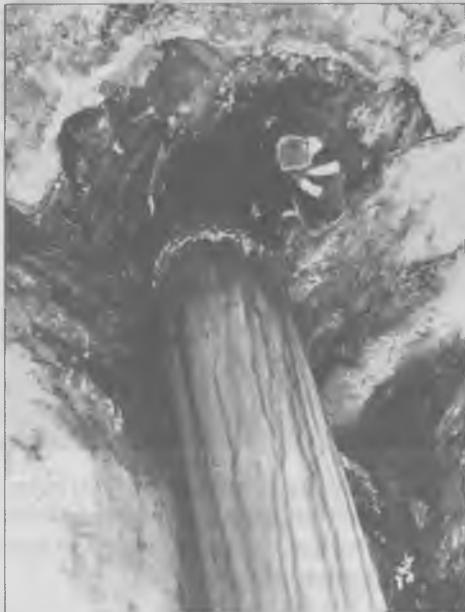
За два года после последнего ремонта плесень совершенно развела потолок и стену. Справа от трубы поселилось целое грибное семейство.
