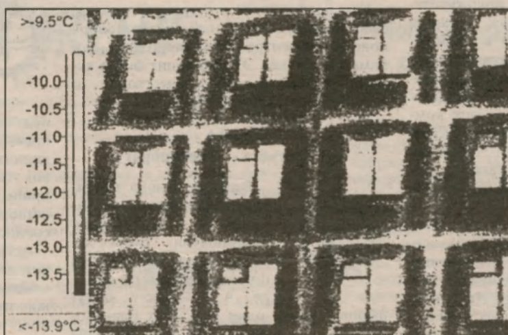
Термограмма 9-этажного панельного жилого здания постройки 80-х годов с внутрипанельными отопительными приборами. Белые просветы - это утечки тепла.
