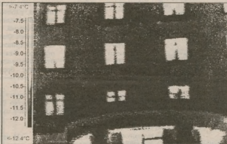
Термограмма жилого здания "сталинской" постройки.
