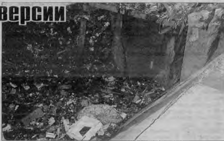
Мусоросборочная яма после пожара.
