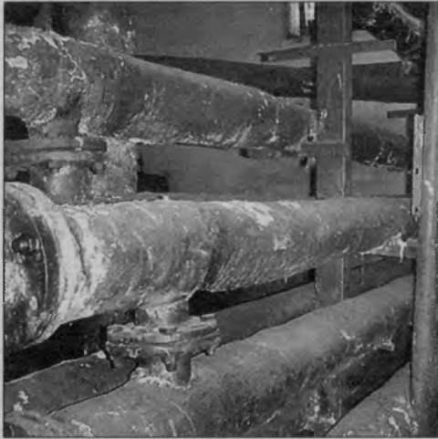
Старый бойлер и новый теплообменник по адресу: улица Воровского, 21.
