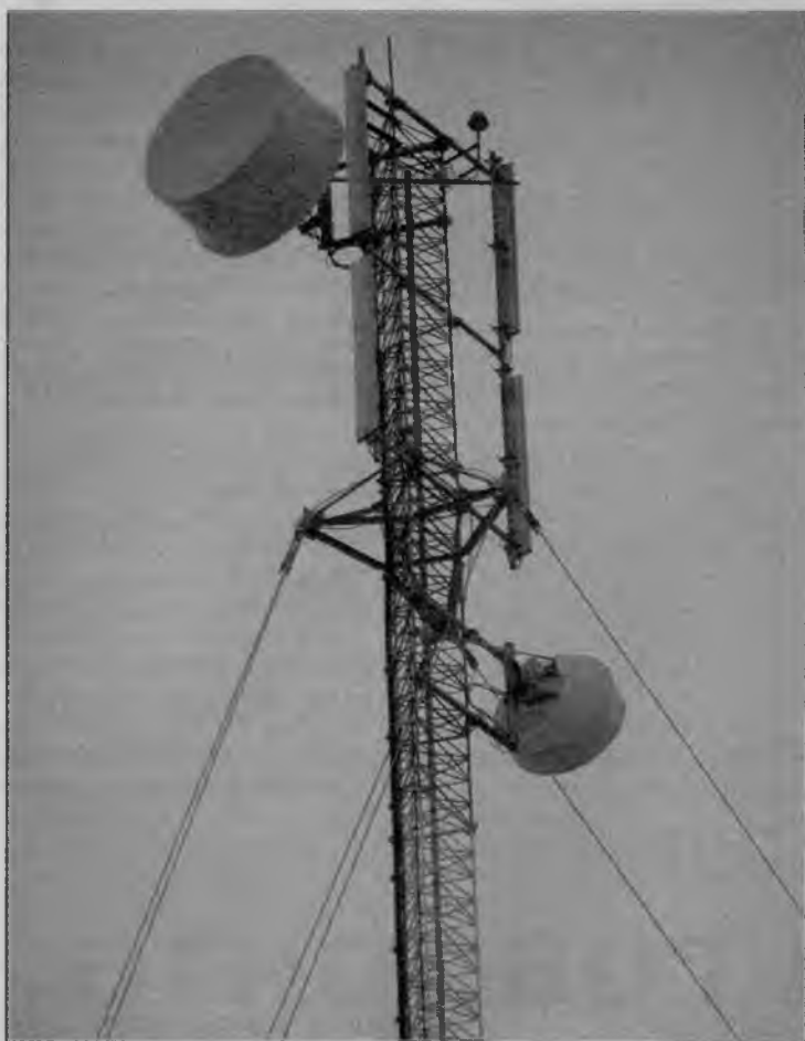
Башня с приемопередающими антеннами.
