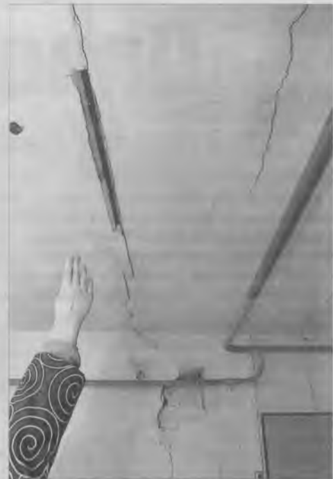
Трещины в этом доме безде: на потолке и на фасаде.
