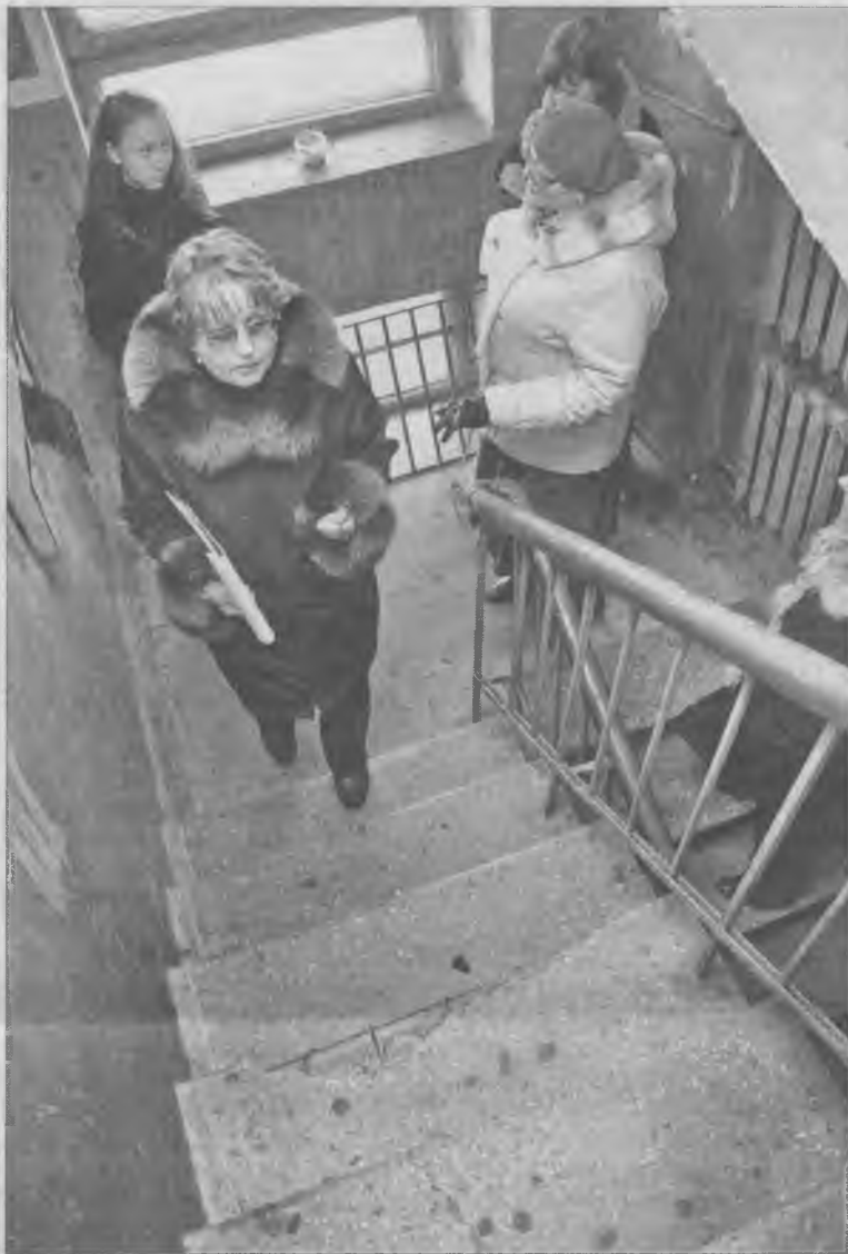
Разрушенные ступеньки и обшарпанные стены в подъезде вызывают недовольство жильцов.
