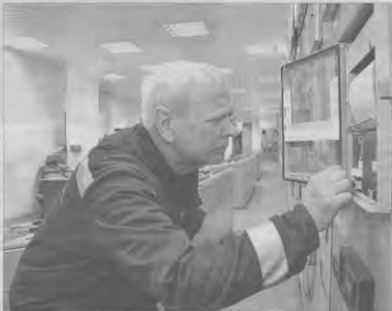
Центральный тепловой щит управления котельной.
