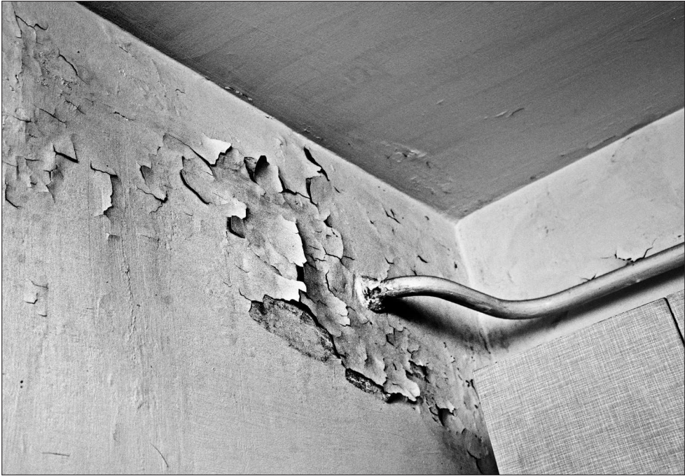
От вибрации со стен осыпается штукатурка.
