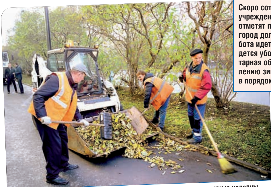
Листву и мусор убирают, чтобы потом они не попали в дождеприемные колодцы.
