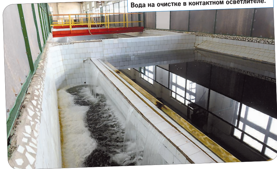
Вода на очистке в контактном осветлителе.
