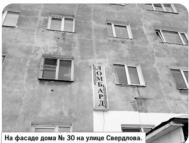
На фасаде дома № 30 на улице Свердлова.
